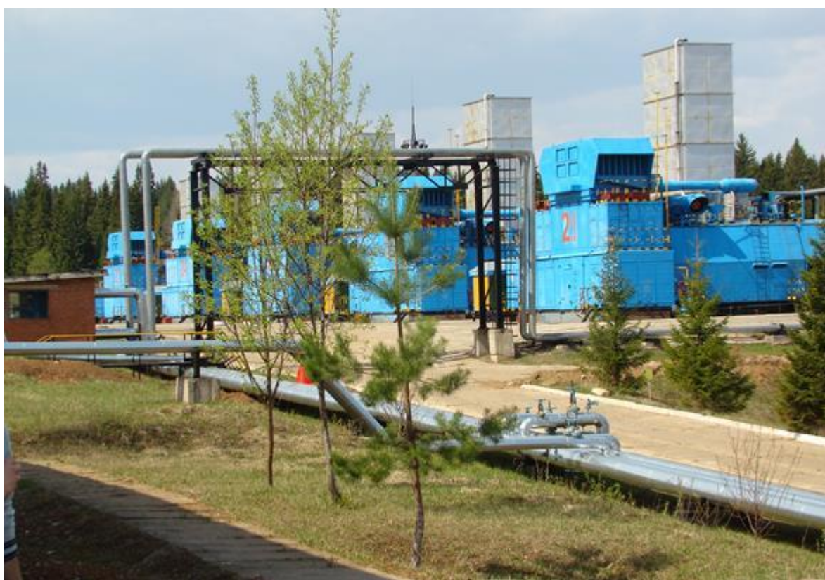
Рис. 2. КС в блочном исполнении ГПУ-16
